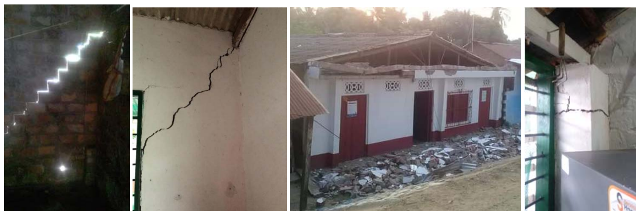
Fig. 6. Daños registrados: (a) mampostería no reforzada, (b) adobe, (c) parapetos, (d) sistemas combinados. Fotos cortesía del Arq. Foad Hazbun P.
